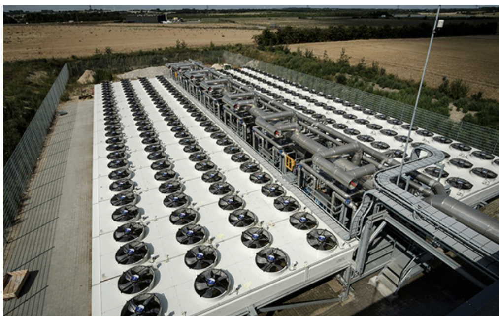
FIGUR 13: KØLEGÅRD TIL LUFTVARMEPUMPEANLÆG.
