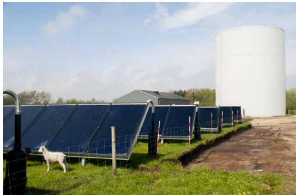
FIGUR 15: SOLFANGERFELT TIL FJERNVARME OG AKKUMULERINGSTANK (ASAA FJERNVARME)
