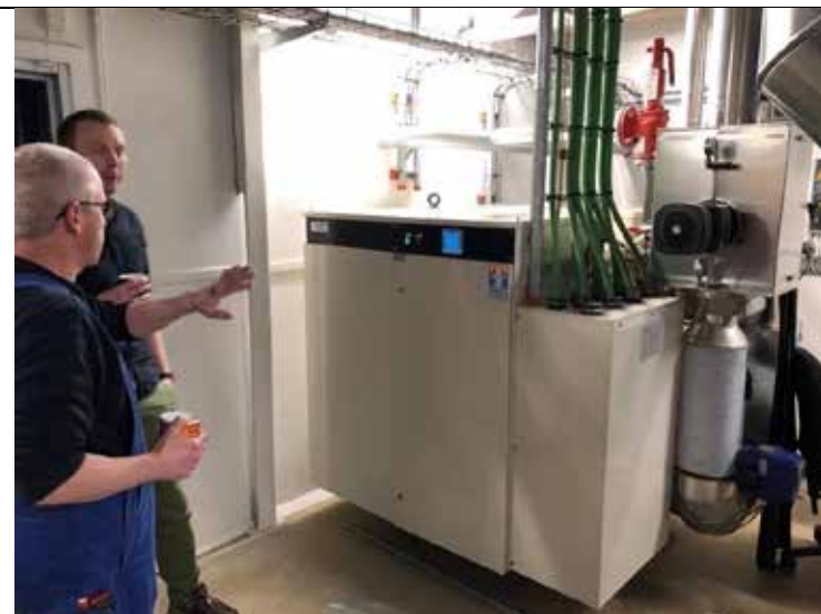
FIGUR 17: 1,5 MW EL-KEDEL, PRÆSTØ FJERNVARME
