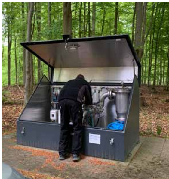
FIGUR 10: STATION VED RÅVANDSBORING (FORSYNING HELSINGØR)
